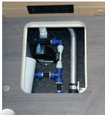
- Zugang zum Frostwächterventil.
